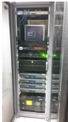
Figura 2: Instalación física de los elementos del clúster de la FCFM de la UAdeC. Fuente: Elaboración propia.
